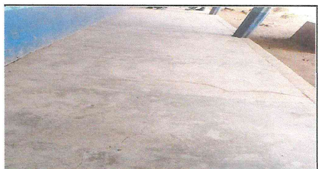
Foto 6: piso del corredor deteriorado.
