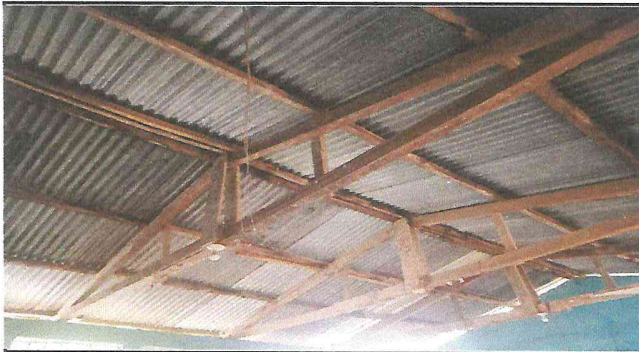
Foto 1: Estructura de madera dañada y corroída por las termitas.
