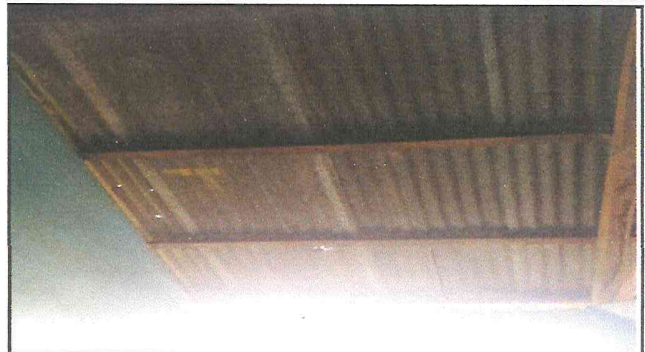
Foto 2: laminas de las aulas y corredor con daños considerables.
