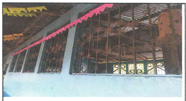
Foto 4: balcones dañados por el oxido.
