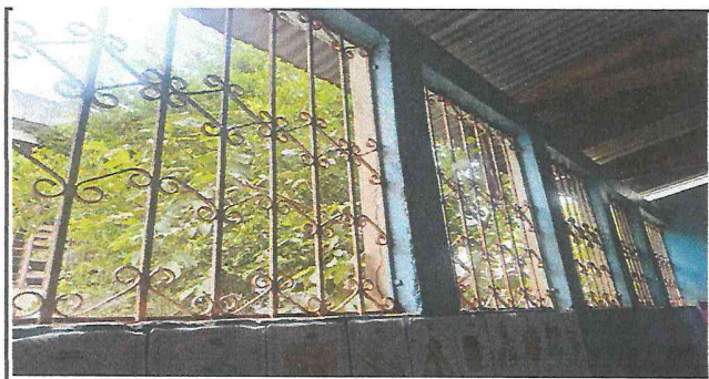
Foto 5: balcones dañados por exposicion a las inclemencias del tiempo.
